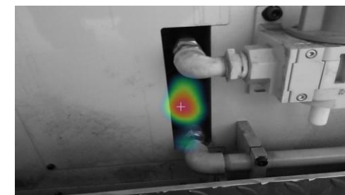
エア漏れ箇所の可視化の様子
