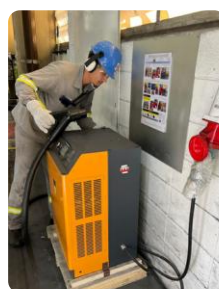
バッテリー充電設備
